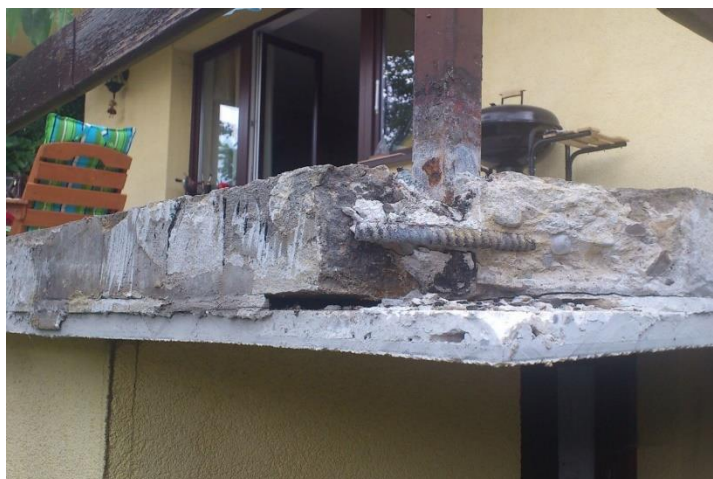
Brak fragmentu betonu
